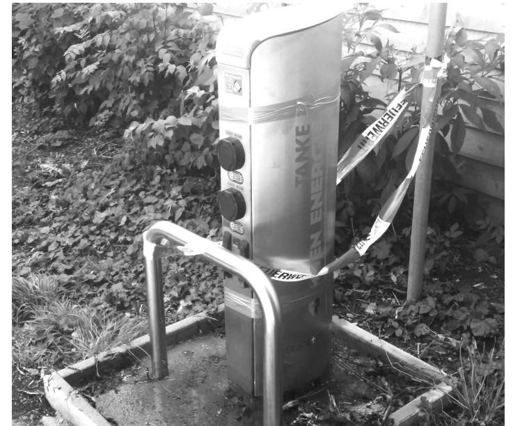
Zwischen September und Dezember kam es in Wien wiederholt zu Sabotagen gegen die Ladeinfrastruktur für Elektroautos in der Stadt. Mehr als sechs Ladestationen wurden von Unbekannten mit Feuer angegriffen und zerstört.
